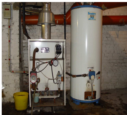
Figuur 1.2: voorbeeld van een oude installatie
