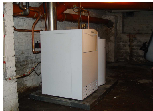
Figuur 1.3: voorbeeld van een nieuwe installatie
