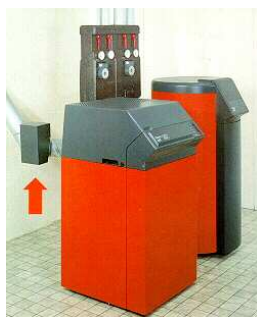
Figuur 7.11: automatische klep in de rookkanalen
