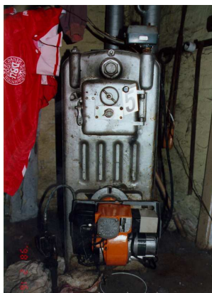
Figuur 7.1: extreem voorbeeld van een oude, niet-geïsoleerde verwarmingsketel
